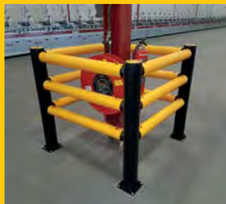
iFlexRail Säulenschutz zum Schutz eines Fallrohres im Fußgängerbereich eines Distributionszentrums.
