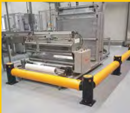
iFlex Verkehrsbarriere Standard zum Schutz von Maschinen in einer Verpackungsanlage.
