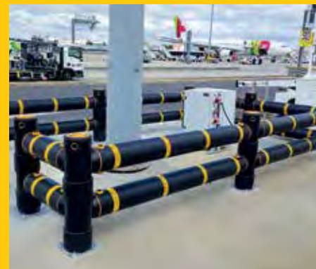
Atlas Verkehrsbarriere Doppelt mit reflektierenden Streifen zum Schutz eines Flughafenmastes und einer Elektroverteilung.
