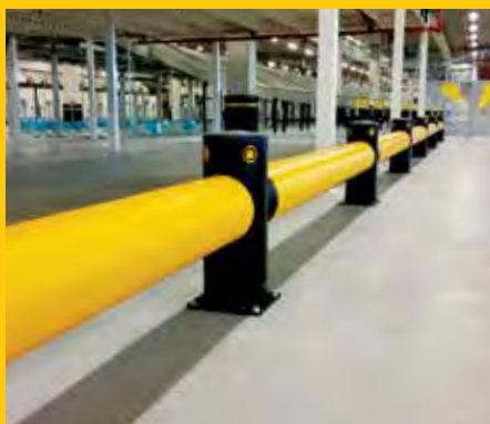
iFlex Verkehrsbarriere Standard zur Festlegung von Fahrwegen in einer neu errichteten Verpackungsanlage.
