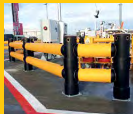
Atlas Verkehrsbarriere Doppelt zum Schutz eines Beleuchtungsmastes auf einem Flughafen.
