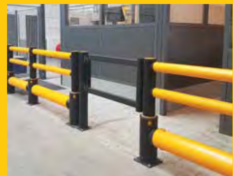
iFlex Schwingtor als Zugang vom Verwaltungsbereich in die Produktion.
